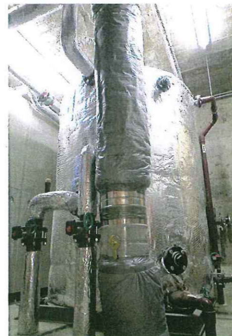
夜間電力により給湯された「湯」を保温貯湯する「貯湯槽」。貯湯された湯は昼間シャワー等に使用される。
